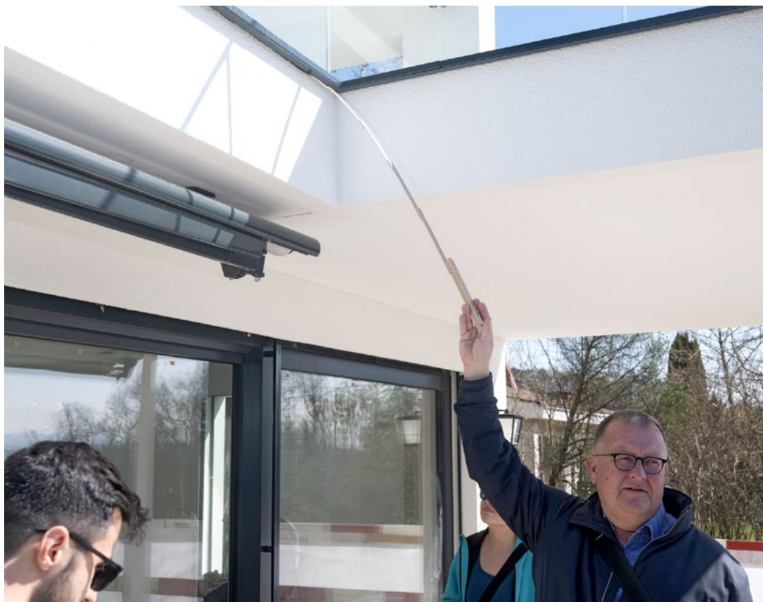
Wohnungsterrasse: Bauexperte Othmar Helbling entdeckt einen Spalt in der Fassade
