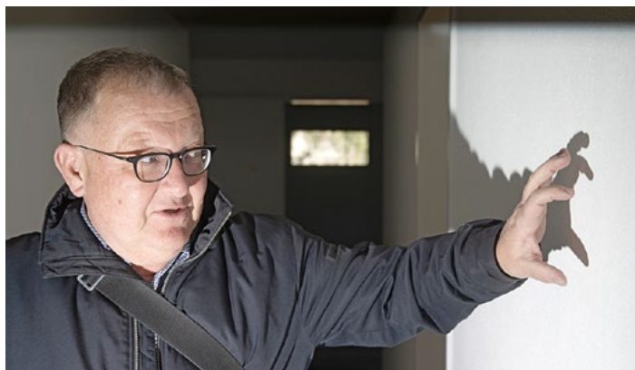
Wandverputz: Laut dem Experten technisch mangelhaft
